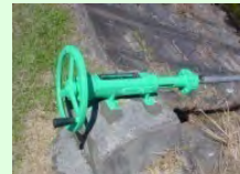
ゲート、バルブの更新
