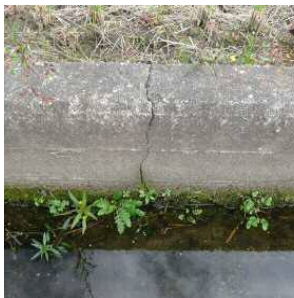
縦方向のひび割れ
