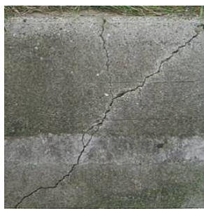
斜め方向のひび割れ
