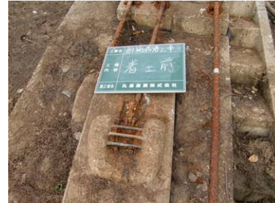
ため池における 老朽化したゲート
