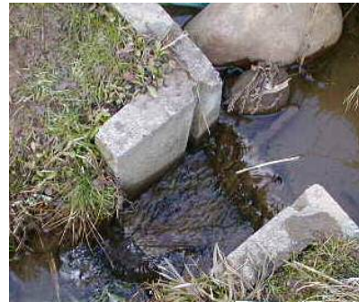
水路との接続部に生じた隙間 (角落しが入らない)
