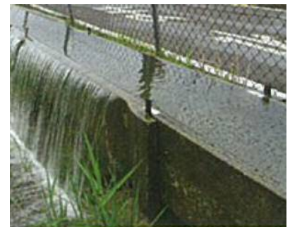
水路からの溢水
