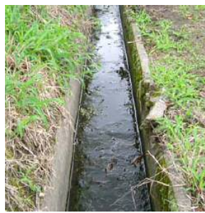
部分的な欠損
