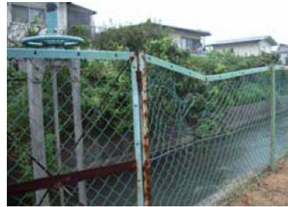
破損した金網フェンス
