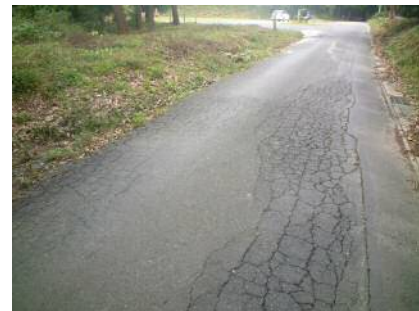
アスファルト舗装の老朽化
