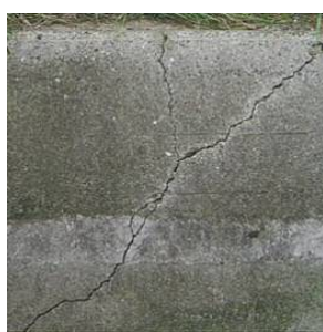
斜め方向のひび割れ
